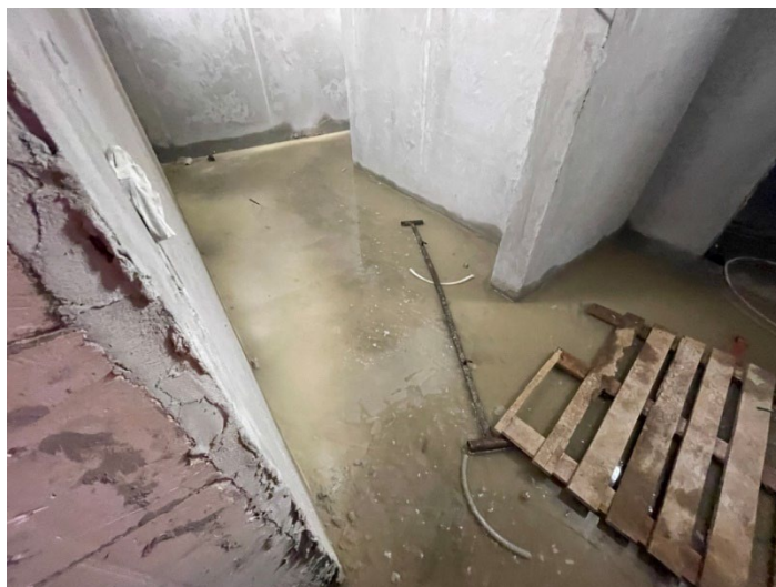
Рис. 1. Протечка в фундаментной плите
