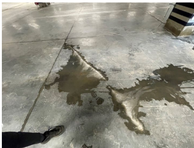
Рис. 2. Трещинообразование в местах длительных протечек
